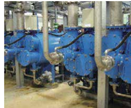
MTG×4台並列設置 (英国浄水場・日量16,000m 3 処理)
