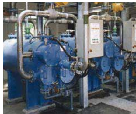
MTG×3台並列設置 (英国浄水場・日量12,000m 3 処理)
