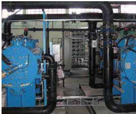
MTG×2台並列設置 (RO膜前処理・日量5,500m 3 処理)
