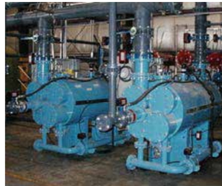
MTG×2台並列設置 (プロセス水処理・日量4,000m 3 処理)
