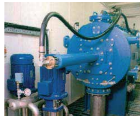
MTG×1台設置 (英国浄水場・日量3,000m 3 処理)
