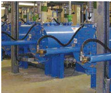
MTG×6台並列設置 (英国浄水場・日量25,000m 3 処理)
