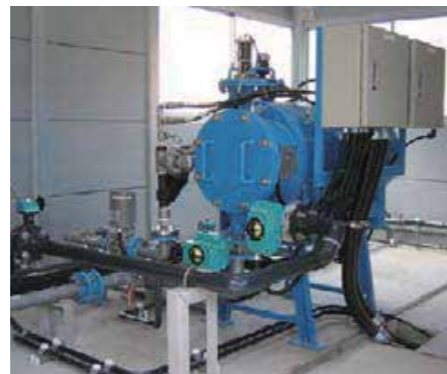
MT22P×1台設置 (広島県内浄水場・日量200m 3 処理)
